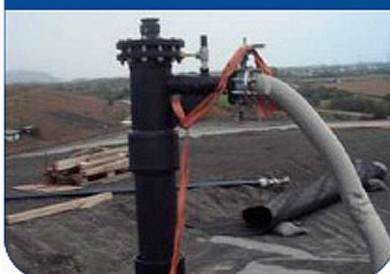
Cabezas Desgasificación Gas Drainage Heads
