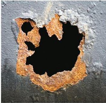
Búsqueda de Pittings. Cañerías enterradas.
